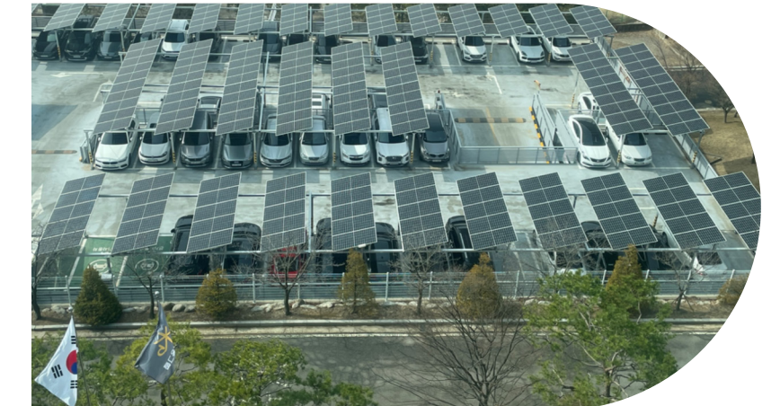
연수원 주차타워 태양광
